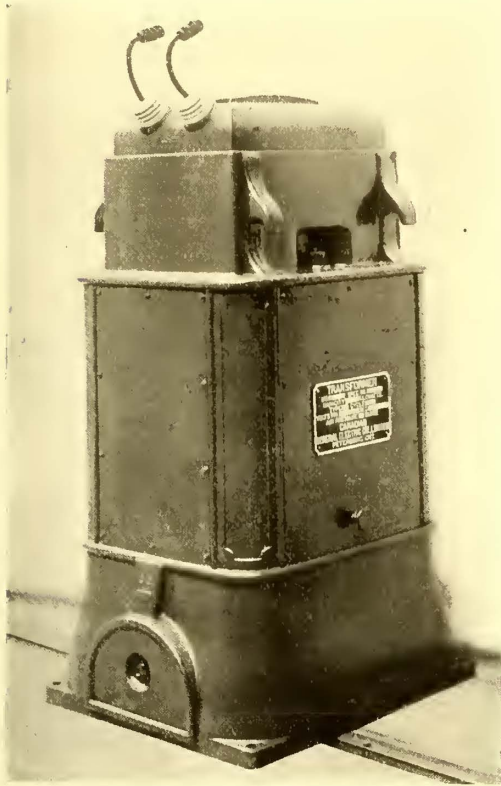
FIG. 8.—AIR BLAST TRANSFORMER
